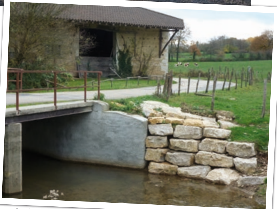
La pile du pont du moulin Blanc a été restaurée par le Syndicat Sevron-Solnan.
